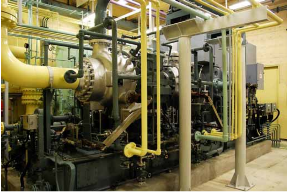
設置したタービン発電機
