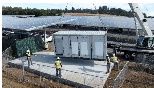
太陽光発電併設型蓄電池
