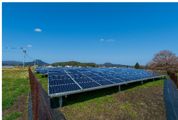
栃木県鹿沼市 上日向発電所(77kW)
