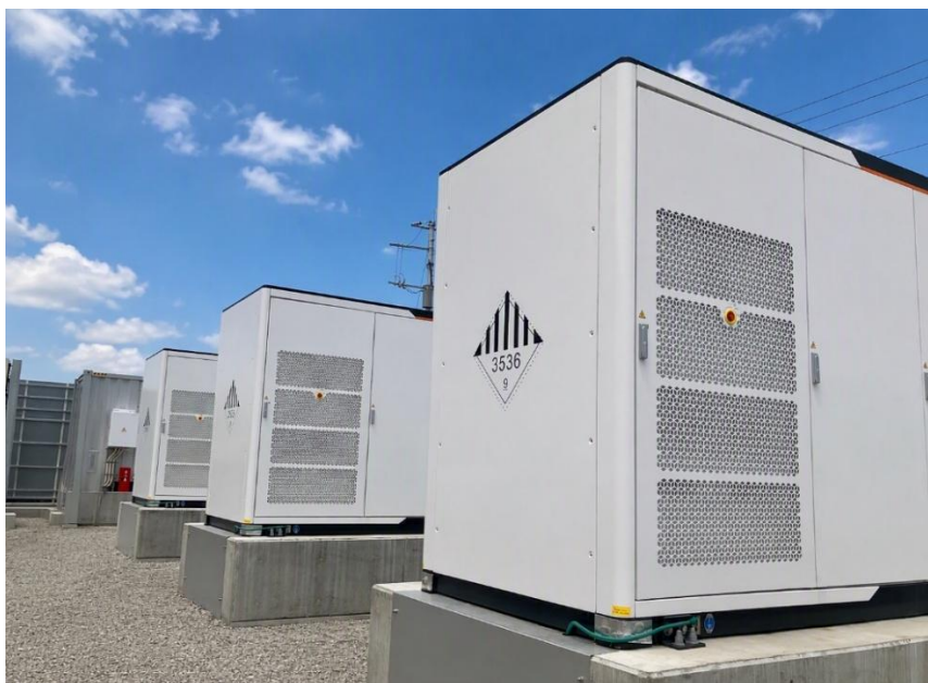
群馬県伊勢崎市の系統用蓄電所（蓄電設備の一部）
