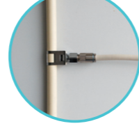
屋外のガス管からの分岐
